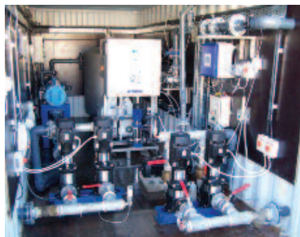
Burrischoole Temporary WTP, Co. Mayo
